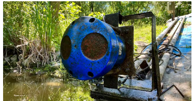
Telepített vízhozammérő berendezés (H-ADCP) (Forrás: NYUDUVIZIG)
