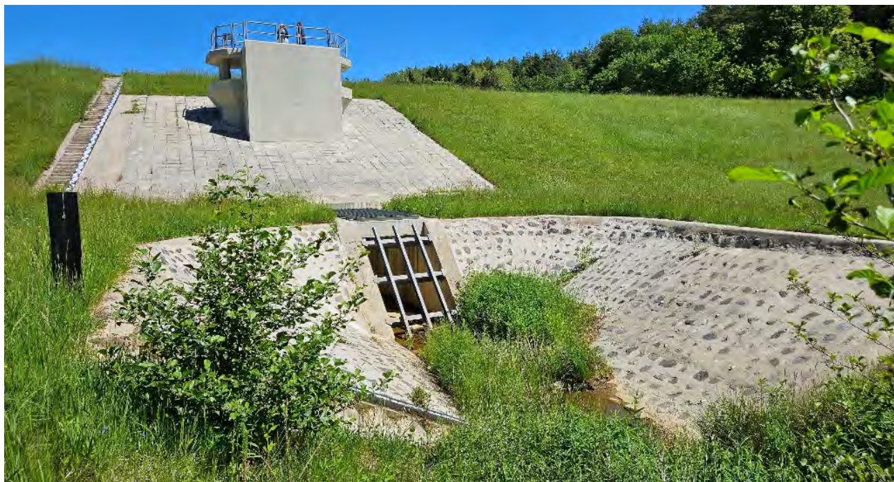
1. ábra: Rábagyarmati Záportározó hordalékfogó műtárgya (Forrás: Gyenis Olivér)
