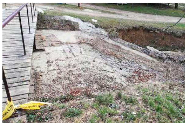
A károsodott töltés (1. kép) és a károsodott árapasztó (2. kép) (Forrás: Déri, 2018; Engi, 2019)
