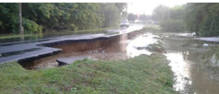
8. ábra: Marótvölgyi-csatorna 20+000 km szelvény útburkolat-rongálódás
