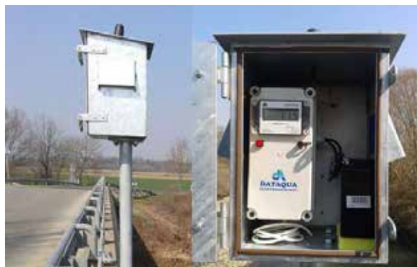
5. ábra Távmerő állomás radaros vízszintmérővel
