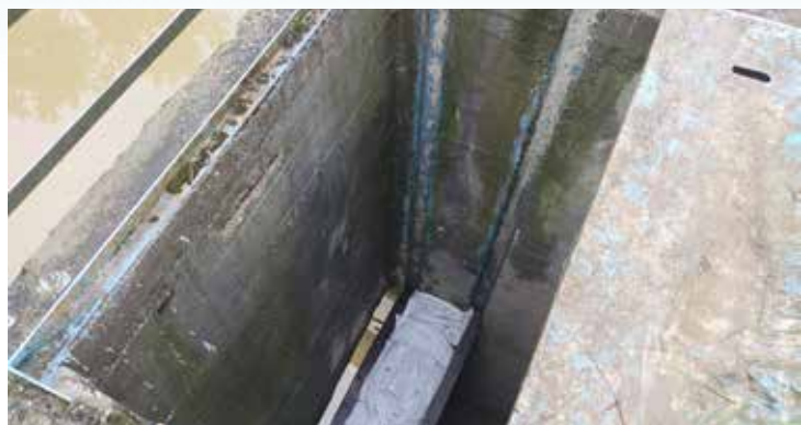
Betétpallós elzárás, Gyurgyánci-zsilip, Murakeresztúr
